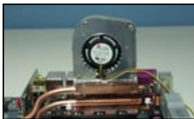
ファンの前後の向きが正しく取り付けられていない。
